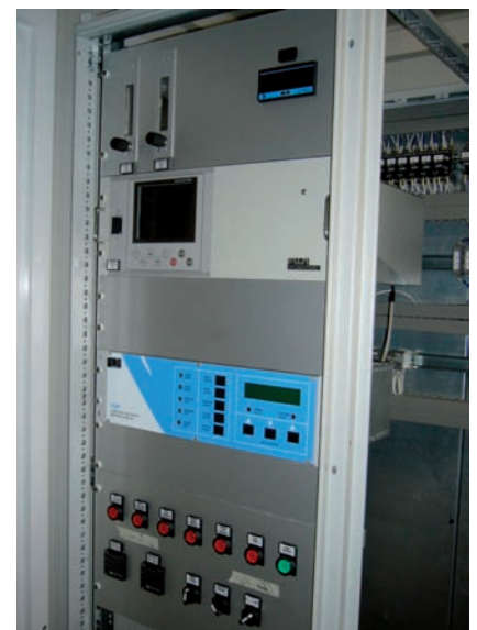
4 - Montaggio rack di un analizzatore di polveri laser
