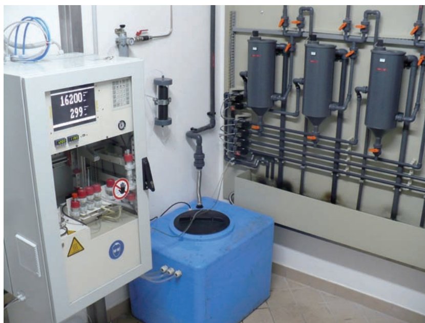
1 - Cabina di analisi delle acque di mare
